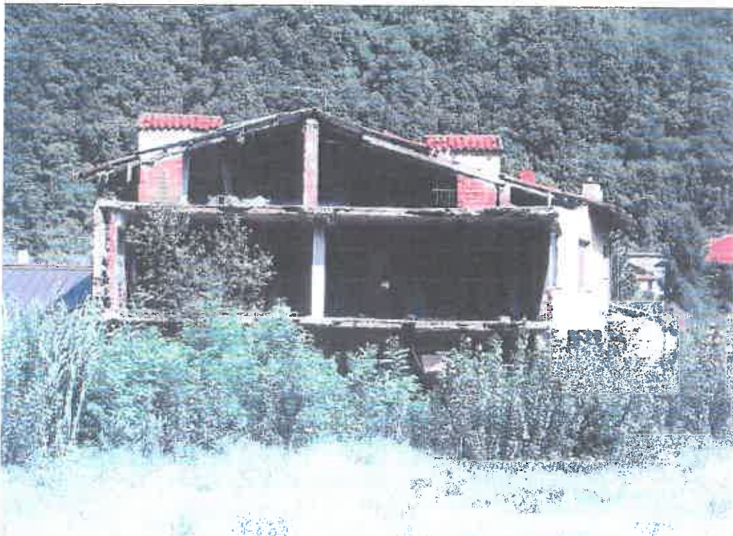
Fig.2 – Torrente Belbo (piena 1994), danni ad un edificio situato sulla sponda destra in corrispondenza della sezione 7.
